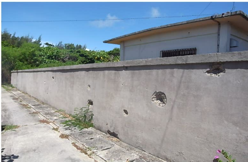
米軍機による機銃掃射の跡が残る宮古南静園の塀の壁。
